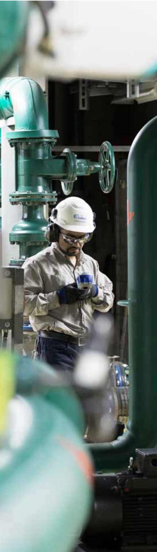
Caverna de Máquinas de la Central Canutillar, Región de Los Lagos.
