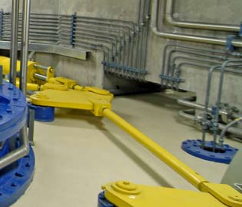
IMAGEN SUPERIOR: Casa de Máquinas, Central Hornitos.
